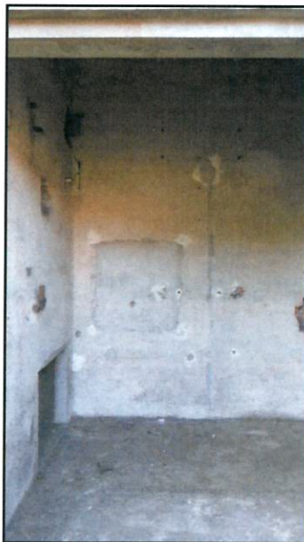
Figure 3 : Local transformateur le 26.6.2013
